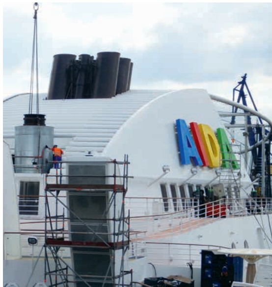
Scrubber-Nachrüstung auf einem Cruise Liner von Aida
